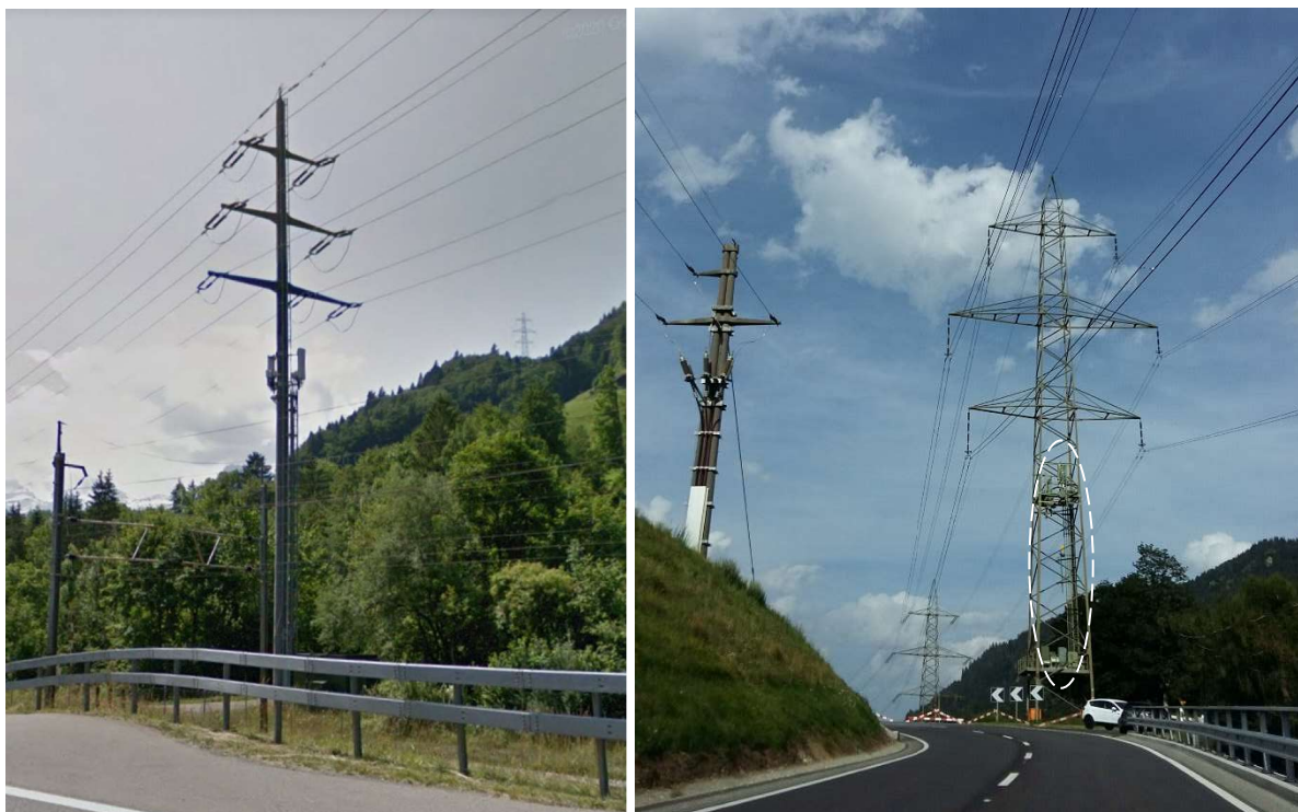
Antenne su elettrodotto presso Spiez (Street view 2019) e Disentis (13.08.2021)
